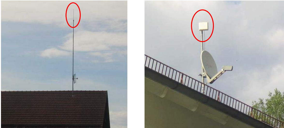
Bild 2.2 Links: WLAN-Basisstationsantenne (Rundstrahlantenne) auf einem Gebäudedach (der unten am Mast angebrachte Richtfunkparabol dient der Anbindung der Station an das Netz); Rechts: Teilnehmerantenne (oben), montiert auf dem Trägerrohr einer Satelliten-TV-Empfangsantenne.
